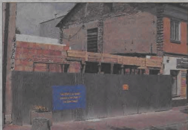
Powoli pną się do góry mury budynku w miejscu gdzie jeszcze niedawno stała kamienica Rubisia.
