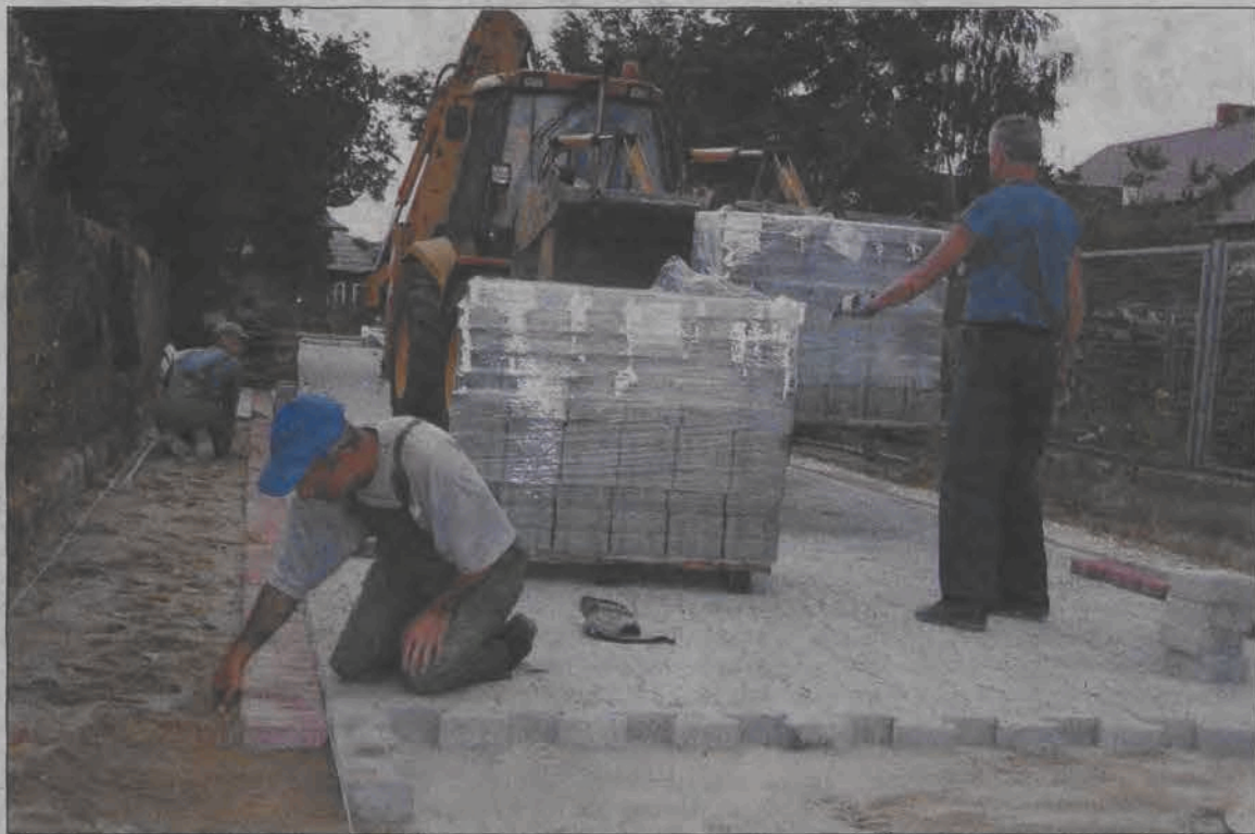
W ubiegłym tygodniu pracownicy ZUK zaczęli układać kostkę brukową na ul. Żeromskiego na Górkach. Z uwagi na wąski pas drogowy powstanie tu ciąg pieszo-jezdniowy bez wyodrębnionego chodnika.
