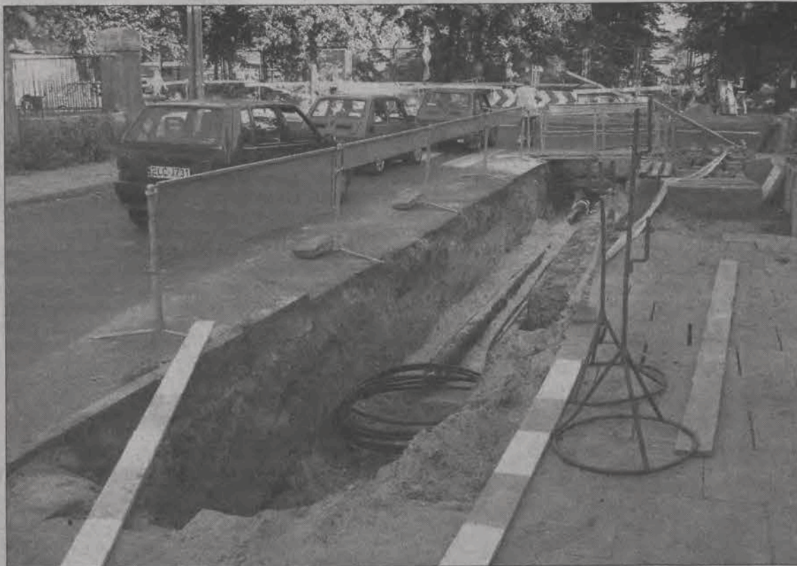
Prace ziemne przy układaniu ciepłociągu prowadzone przy skrzyżowaniu ulicy Starościńskiej z Jana Pawła II tylko nieznacznie przeszkadzają w ruchu samochodów.
