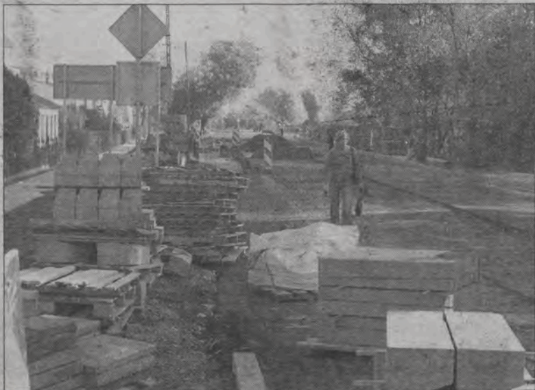
Ulica Warszawska na odcinku od skrzyżowania z Bolimowską do mostu już jest remontowana. Potem prace przeniosą się za Bzurę.
