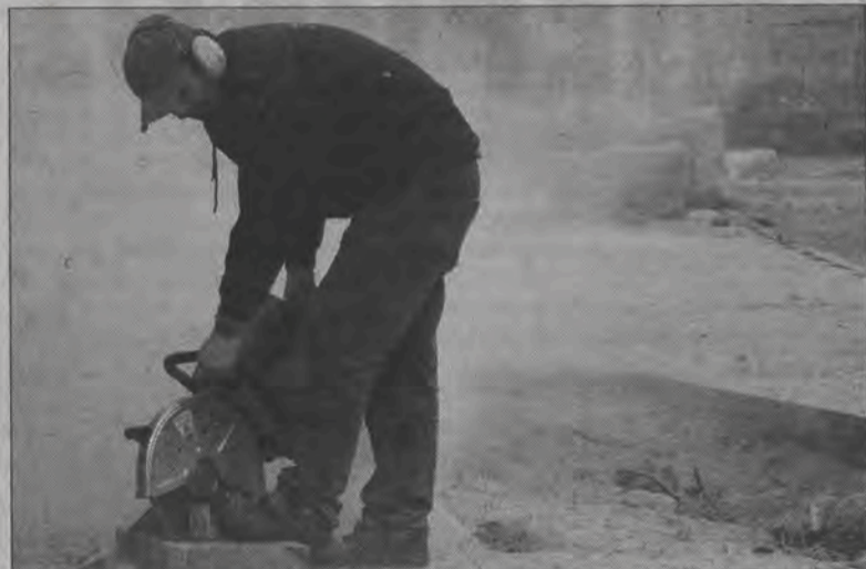
Pył i kurz, robota pali się w rękach - tak spieszą się pracownicy firmy Cezet Bis, aby zdążyć z oddaniem odcinka Topolowej przy cmentarzu w przyszłym tygodniu.
