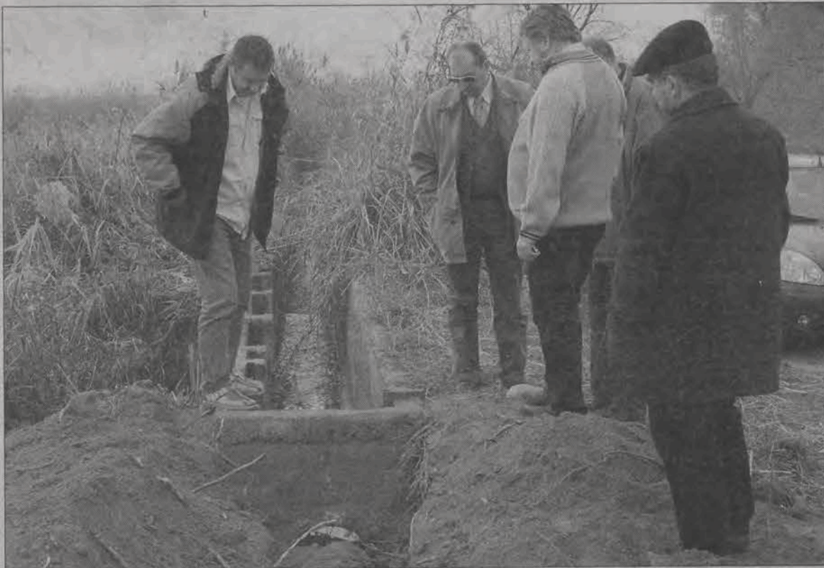
Kierownictwo Zakładu Usług Komunalnych i policja oglądają zniszczenia spowodowane na oczyszczalni ścieków w Łowiczu przez złodziei.
