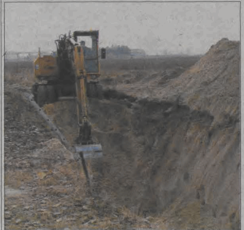
Kanalizacja po drugiej stronie obwodnicy układana jest na głębokości około 4 metrów, dlatego konieczne jest całonocne odwadnianie terenu.
