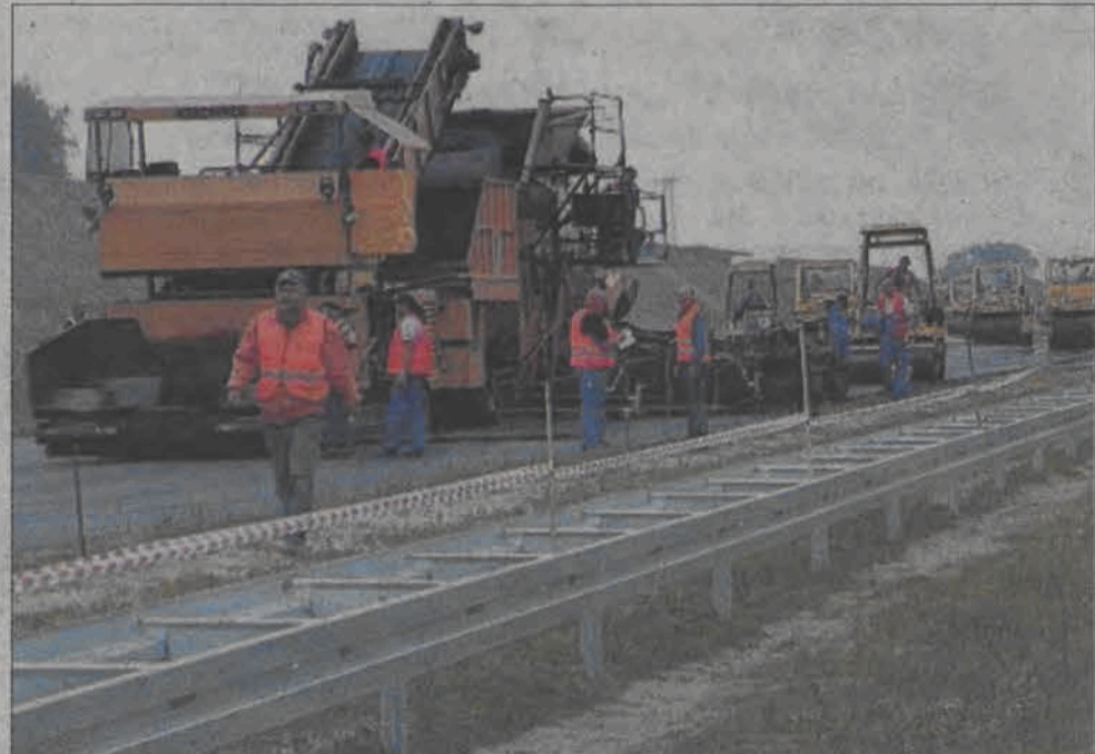
Różne mogą być technologie układania asfaltu na drogach. Zupełnie nową metodę tzw. kompaktasfaltu zaprezentowała 30 września firma Kirchner na odcinku budowanej autostrady A2 pod Strykowem. Dwie górne warstwy asfaltu: wiążąca i ściernista, są w tej metodzie nakładane jednocześnie, gorąca na gorącą, z prędkością od trzech do siedmiu metrów na minutę. Zapewnić ma to uzyskanie odpornej na odkształcanie, wysokiej jakości nawierzchni jezdni.
