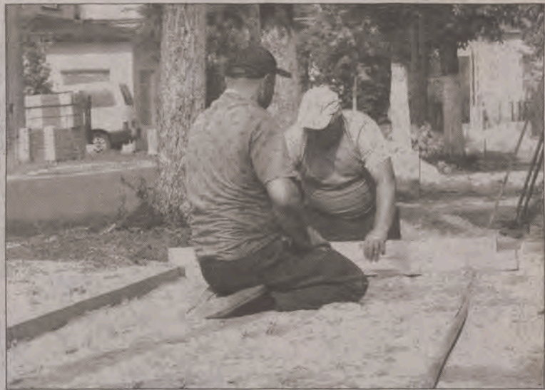
CHODNIK WSPÓLNYMI SIŁAMI. Trwa przekładanie chodnika na ul. Kościuszkę w Strykowie. Przedsięwzięcie wykonywane jest wspólnymi siłami Zarządu Dróg Wojewódzkich z oddziałem w Poddębicach oraz Jednostki Robót Publicznych w Strykowie. Materiał zapewnił ten pierwszy, a robocizną ta druga. Jeszcze w tym tygodniu wojewódzki zarządca drogi ma zamiar wykonać nową nakładkę asfaltową na ul. Kolejowej i wymienić część okrawężnika. (ljs)
