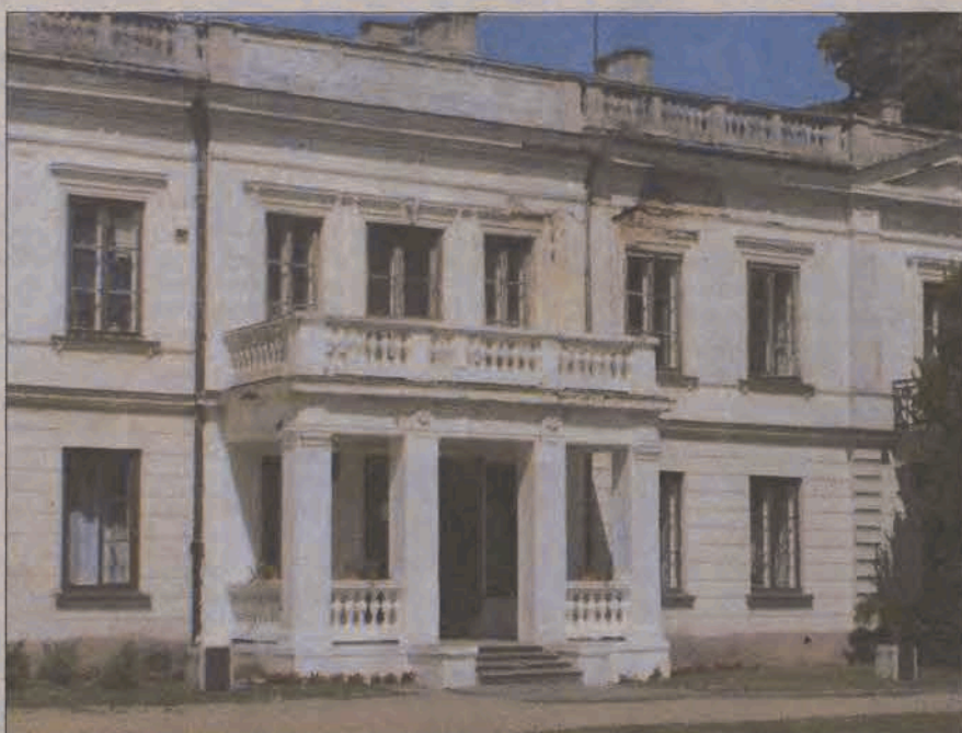
Zniszczenia elewacji pałacu w Sannikach są spowodowane stanem dachu. Na kapitalny remont obiekt musi jeszcze poczekać.
