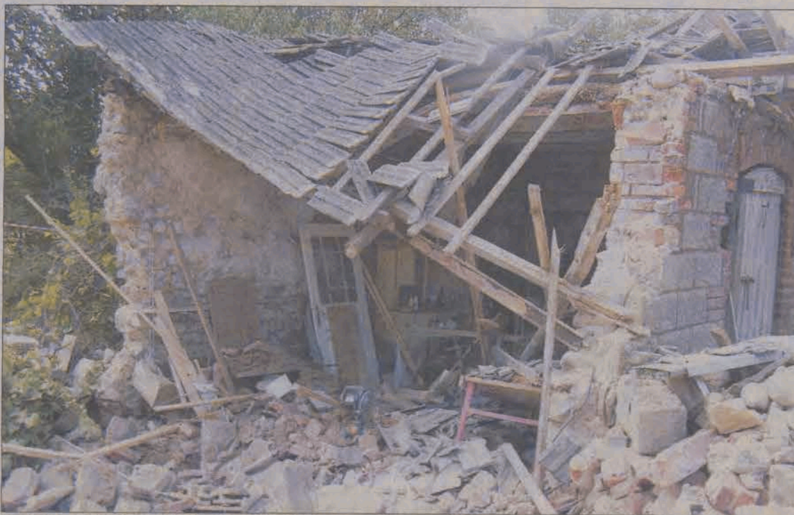
Pod gruzami zawalonej ściany tego budynku gospodarczego śmierć na miejscu poniosło dwóch murarzy.
