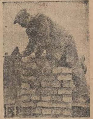
Rośnie tempo prac przy budowie Marszałkowskiej Dzielnicy Mieszkaniowej. Na zdjęciu — murarz, Franciszek Witek, pracujący na budowie bloku II A osiąga 280 procent normy.
