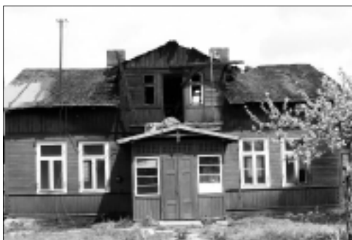
Spaleniu uległo całe poddasze drewnianego budynku.
