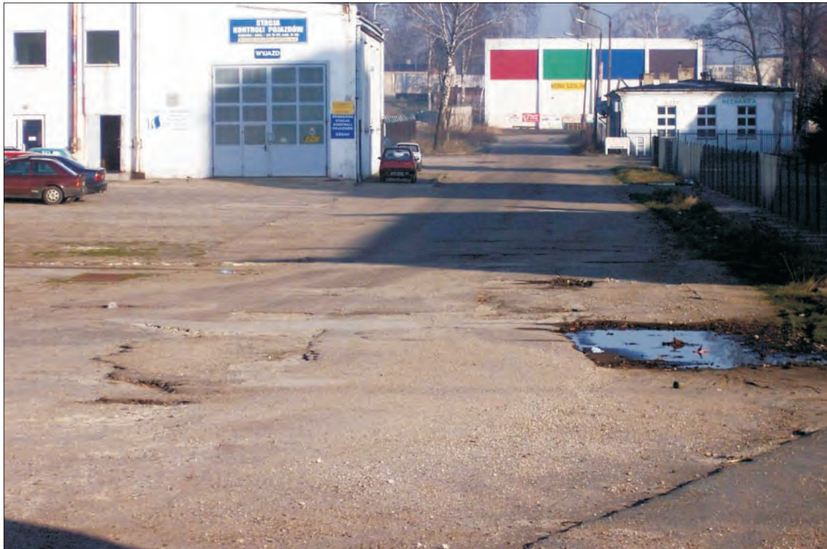
Ten odcinek drogi jest w najgorszym stanie.
