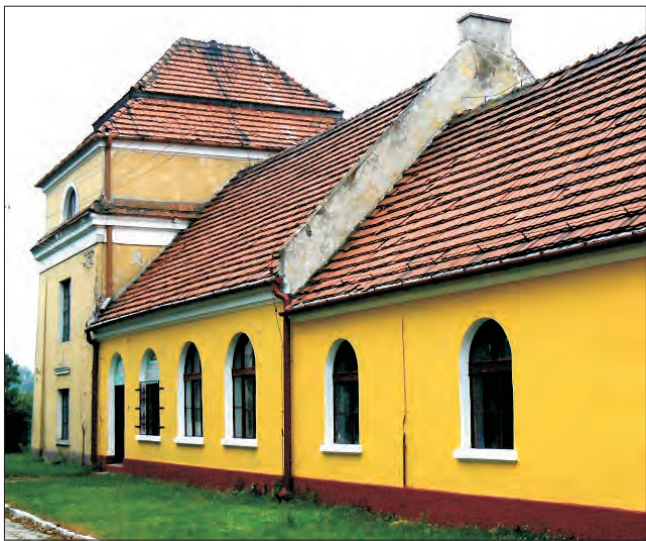
Główna część spichlerza czeka na remont (w głębi), elewacja dolnej parterowej części została w podstawowym zakresie już odnowiona.
