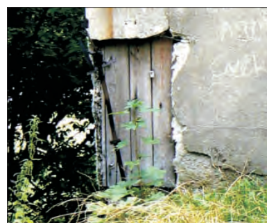
Spod zewnętrznego tynku wygląda stara, drewniana konstrukcja.
