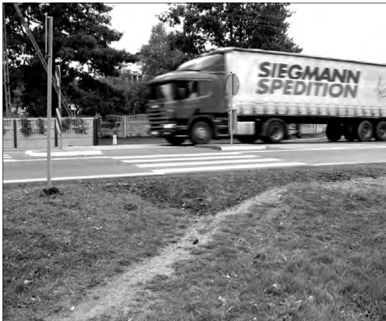
Z przejścia dla pieszych przy skrzyżowaniu ulic Głównej i Kolejowej w Domaniewicach wchodzi się wprost do... rowu.
