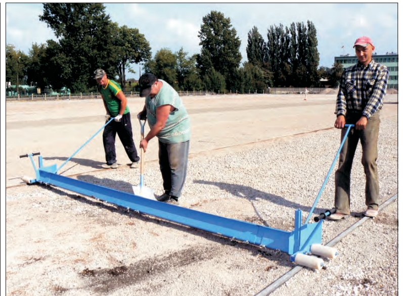
Na boisku OSiR trwa ręczne i mechaniczne równanie podbudowy, na której zostanie ułożona sztuczna murawa.
