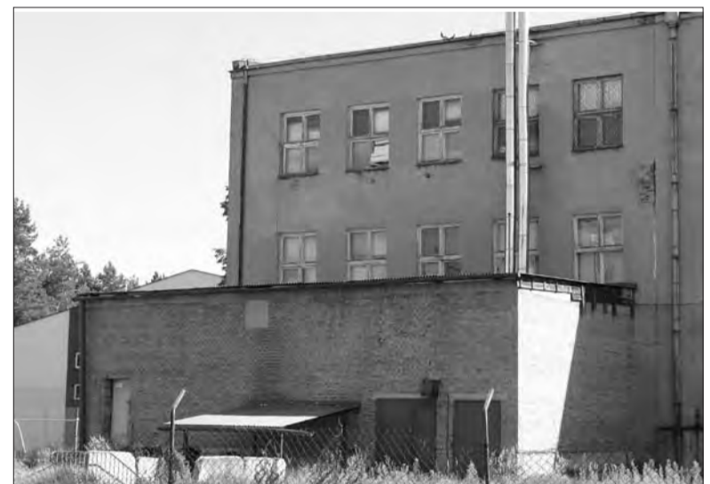
Nowa kotłownia opalana ekogroszkiem ma wyeliminować z użycia tę kotłownię olejową, zlokalizowaną przy dawnej siedzibie SP2. Nie nastąpi to jednak w tym roku.
