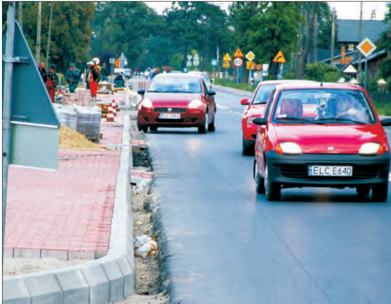
Nie tylko zjechać z podjazdu na posesję jest trudno, ale także sforsować krawężnik, który jest bardzo wysoki.
