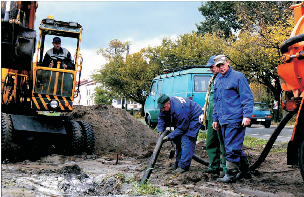
Pracownicy ZUK, zanim przystąpili do naprawy, musieli odpompować wodę z dołu, w którym znajdowała się rura wodociągowa.
