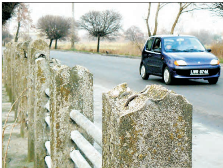
Nowy asfalt, krawężniki i chodniki, a barierki stare jakby przeniesione z zupełnie innego miejsca - ul. Kaliska.
