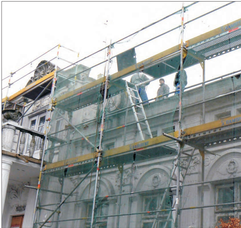
Prowadzone przez toruńską firmę prace na dachu pałacu ujawniły konieczność przeprowadzenia napraw nieprzewidzianych w projekcie i kosztorysie.
