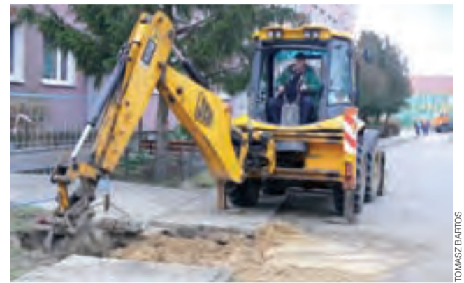
Awaria wodociągowa na os. Dąbrowskiego została dość szybko usunięta, przez kilka godzin wody nie mieli mieszkańcy budynków nr 21 i 20.
