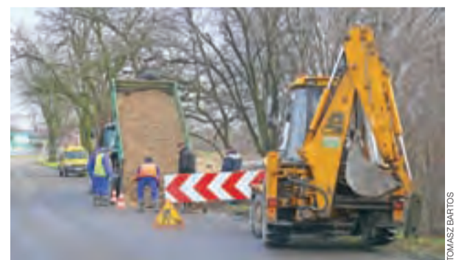
Na ulicy Nadburzurzańskiej do awarii doszło w pasie drogowym, aby dostać się do uszkodzonej zasuwki trzeba było rozkopać jezdnię.
