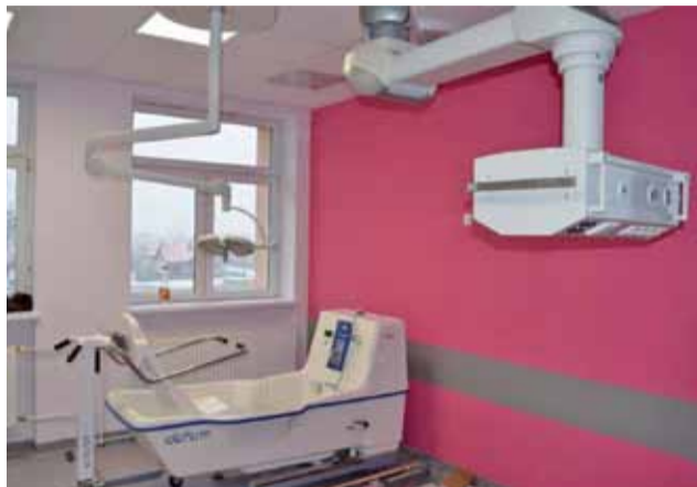
W sali porodów rodzinnych zamontowano wannę do porodów w wodzie.
