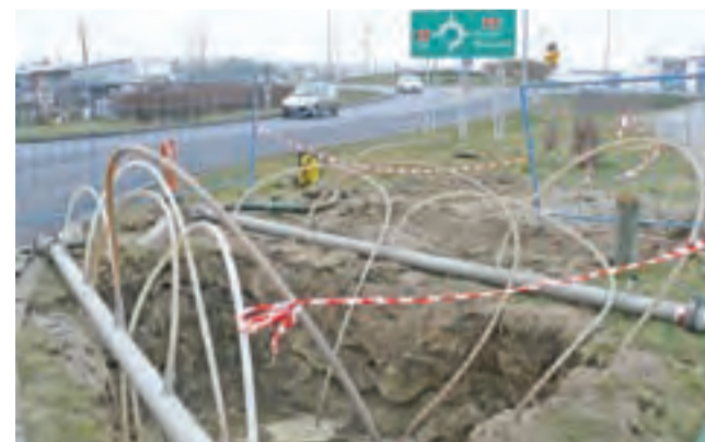
Miejsce awarii wodociągowej w ulicy Jana Pawła II znajduje się na łuku jezdni, który stanowi dojazd do ronda w ul. Prymasowskiej i Łódzkiej.
