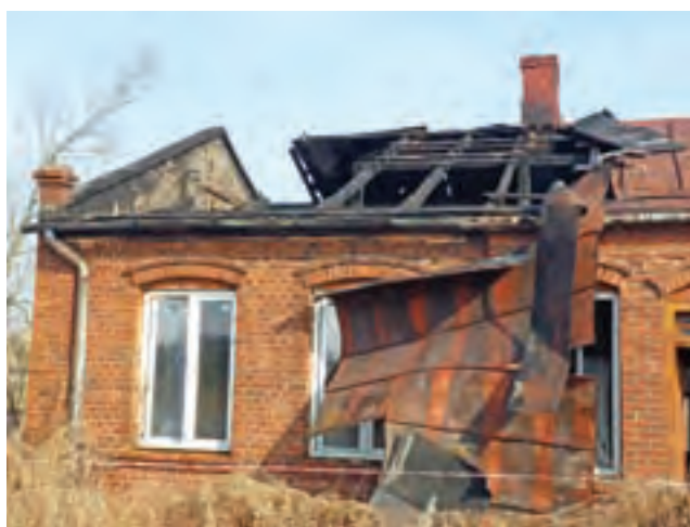
Uszkodzenia pustostanu w Dąbkowicach Górnych po niedzielnym pożarze.
