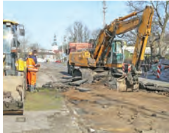
W środę 4 kwietnia, dwie godziny po zamknięciu ruchu, pracownicy firmy Trakt usunęli już duży fragment nawierzchni na ul. 1 Maja.
