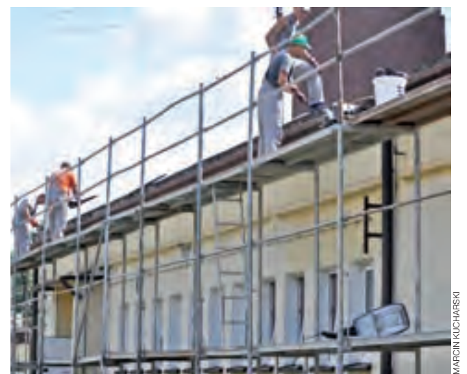
Prace przy termomodernizacji przedszkola rozpoczęły się od demontażu obróbek blacharskich przy dachu.
