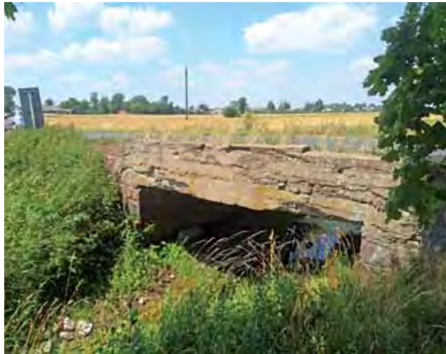
Most w Bąkowie od dawna wymaga gruntownego remontu.
