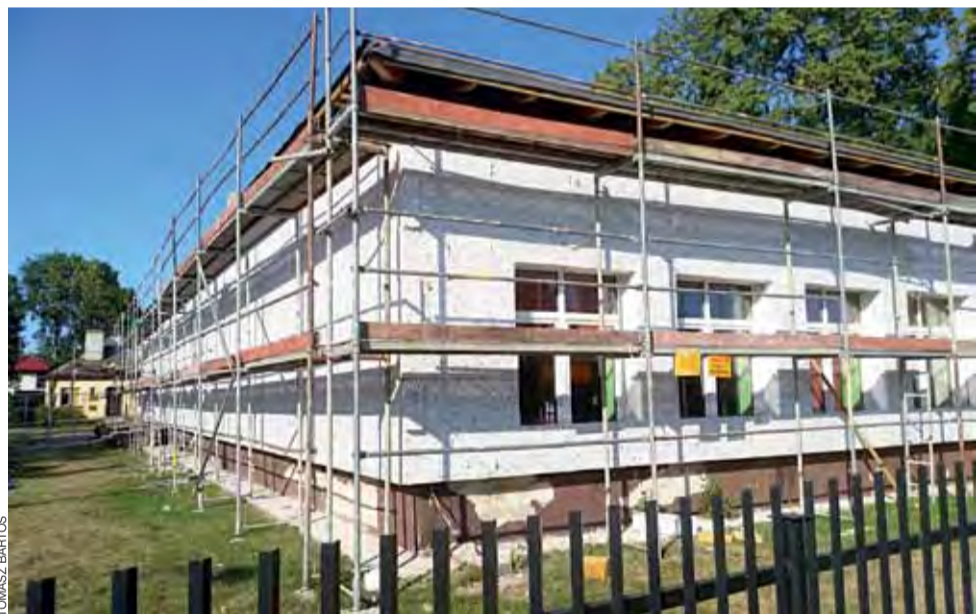
Przedszkole nr 5 w Łowiczu otoczone jest obecnie rusztowaniami, trwają prace przy wymianie dachu i dociepleniu ścian.
