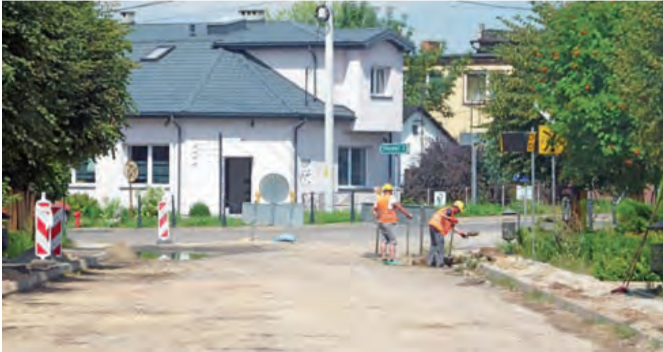
Na budowie. Wyłączona z ruchu, przebudowywana droga wojewódzka nr 703 w Bielawach, stan prac na 26 lipca br.
