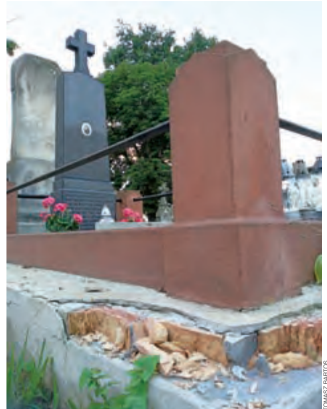
Tak wygląda obecnie remontowany w 2011 roku pomnik, w którym pochowany jest społecznik i radca miejski Maurycy Klimecki. Rozpadająca się podmurówka, krusząca się cegła – członkowie PTTK chcą to naprawić we własnym zakresie.
