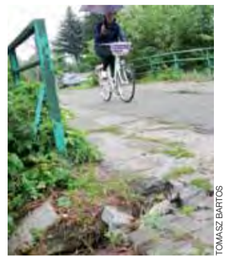
Woda wymyła ziemię spod nawierzchni asfaltu i kostki, powodując jej zapadnięcie.
