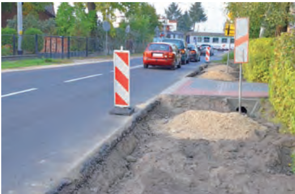
Rozkopane pobocza Alei Legionów w sąsiedztwie przejazdu kolejowego w Bednarach – na zdjęciu widać wjazd na jedną z posesji i przepust, który odprowadzał wodę do zasypanego rowu.
