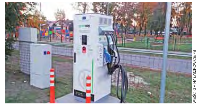
Stacja ładowania pojazdów w Łyszkowicach przygotowana do uruchomienia.
