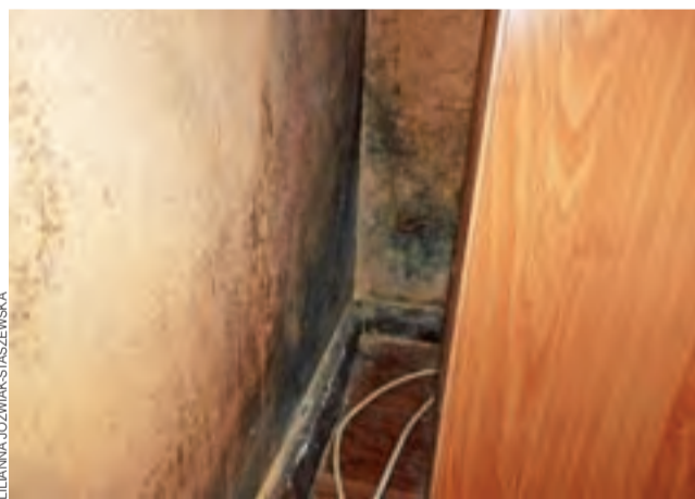
Tak wyglądają ściany mieszkania komunalnego w Niesułkowie Kolonii. Jego lokator od lat bezskutecznie ubiega się o zamianę, ale gmina za każdym razem odmawia.
