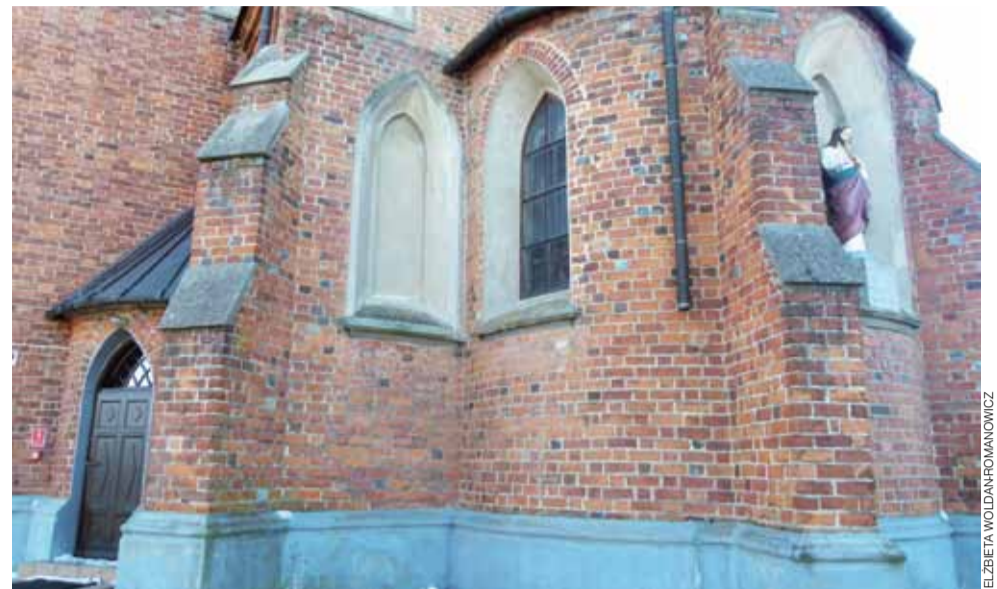
Jedna z częściowo oberwanymi rynnami. Złodzieje zdemontowali ją do takiej wysokości, do jakiej dali radę sięgnąć.
