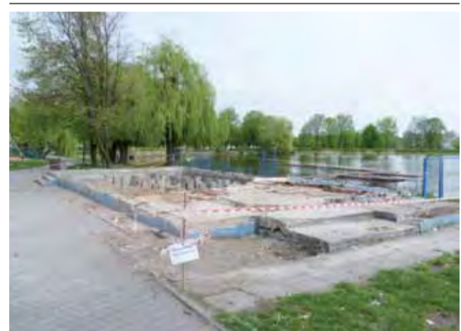
Rozbiórka dobrze znanego wszystkim głownianom budynku wypożyczalni sprzętu pływającego nad zalewem Mroźczka trwała zaledwie kilka dni. Po budynku pozostały już tylko fundamenty. Docelowo w tym miejscu ma powstać restauracja. Wypożyczalnia ma być z kolei prowadzona w specjalnych kontenerach. ki
