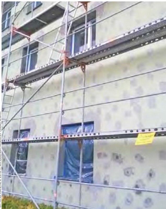
Członkowie wspólnoty z własnych kieszeni musieli m.in. pokryć koszty naprawy ocieplenia ściany szczytowej.
