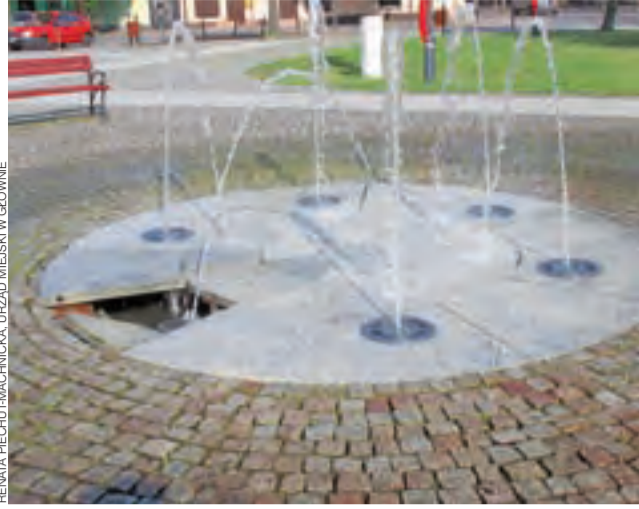
Uszkodzona fontanna. Zdjęcie z 3 maja.
