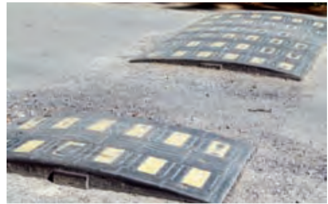
Progi przy ul. Wigury uległy przez lata zniszczeniu.
