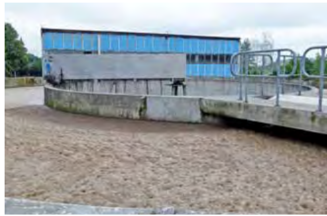
Projektowa przepustowość strykowskiej oczyszczalni ścieków, czyli 1700 m sześciennych na dobę, jest już w tej chwili w pełni wykorzystywana. Na zdjęciu jeden z biobloków z osadnikiem wtórnym.
