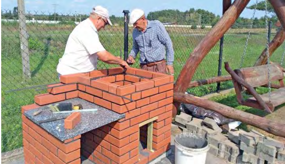
Budowa grilla w Ziewanicach. Dotację wydano na materiały, prace budowlane mieszkańcy wsi wykonali nieodpłatnie.
