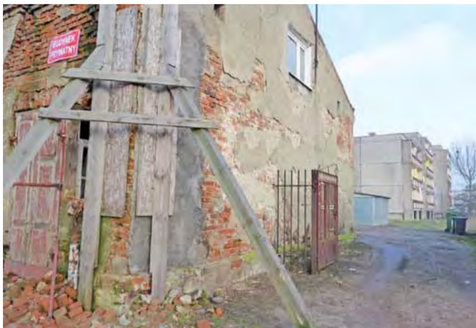
Szans na zabezpieczenie rozwalającego się budynku na razie nie ma, ale jest realna szansa, że uda się uregulować własności gruntowe pod budynkiem Traugutta 18, który widać w oddali.
