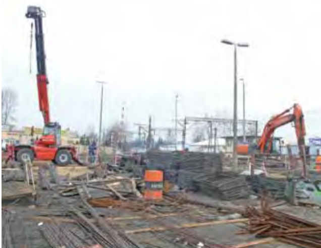
Wykonywanie żelbetonowych konstrukcji fundamentów i podpór wymaga zgromadzenia dużej ilości prętów zbrojeniowych.
