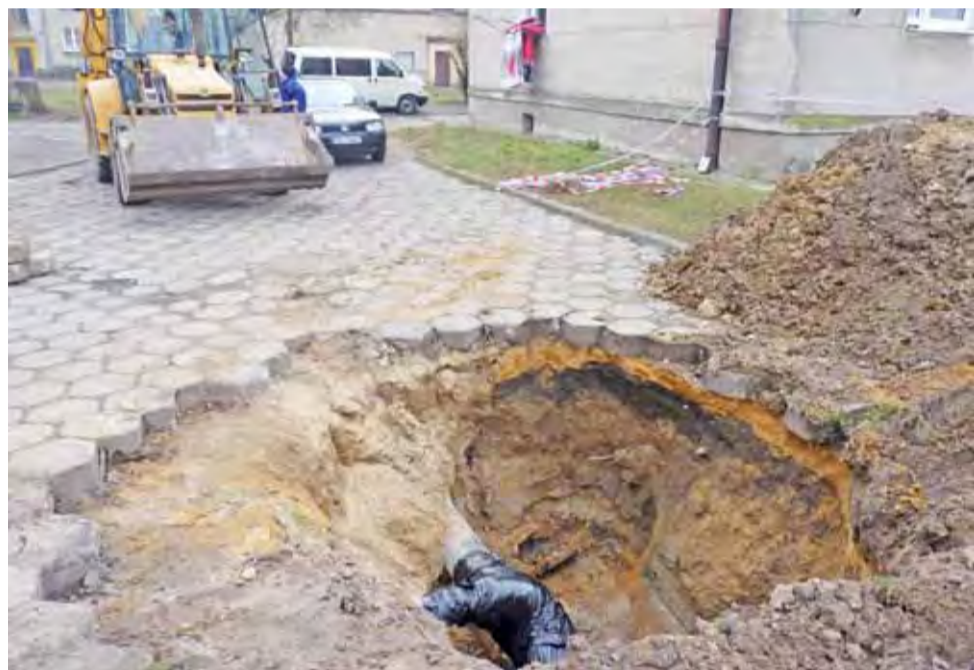
W pobliżu bloku Narutowicza 85b nastąpiła awaria ciepłociągu. Większych utrudnień nie było. Na pękniętej rurze założono opaskę uszczelniającą.
