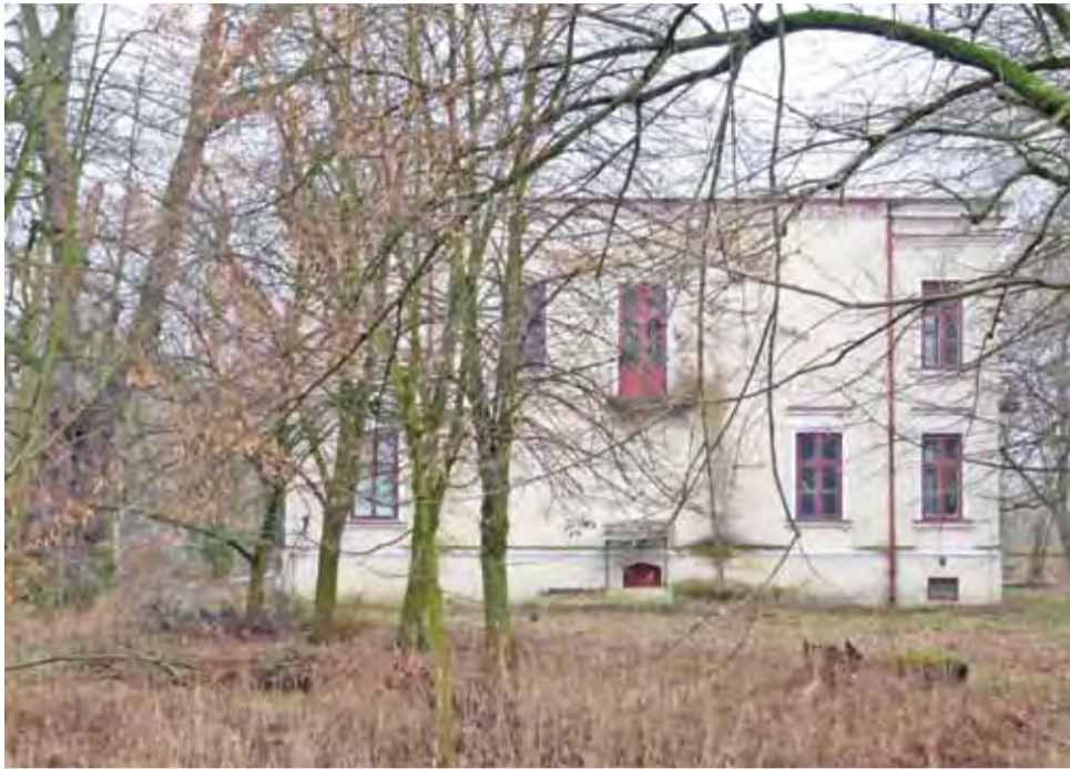
Dwór w Psarach. Widok zza ogrodzenia na zawilgoconą ścianę szczytową budynku. Stan na 2 lutego.
