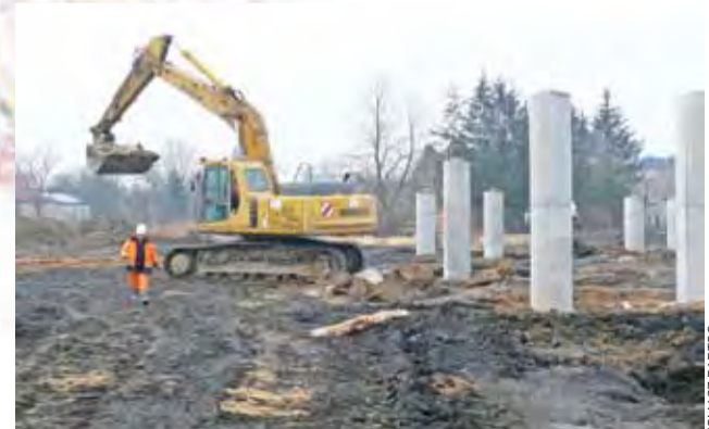
W tym tygodniu zaczęto zasypywać fundamenty podpór, na których oparta zostanie pochylnia dla rowerzystów i osób niepełnosprawnych poruszających się na wózkach.
