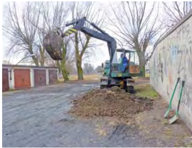
Awarię na wodociągu wody surowej o średnicy 250 mm usuwano w poniedziałek. Awaria nastąpiła przy ul. Łąkowej, pomiędzy garażami.
