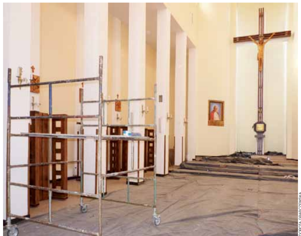
W piątek 9 marca, parafialna kaplica była umalowana. Sprzątano rusztowania i folie zabezpieczające.
