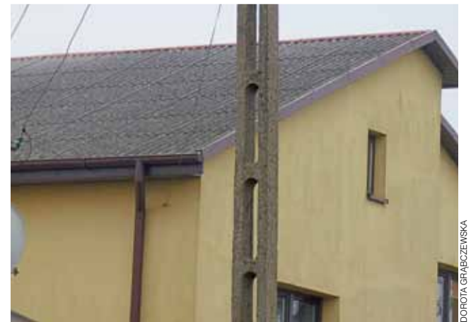
Do 2032 roku eternitowe dachy muszą zniknąć.
