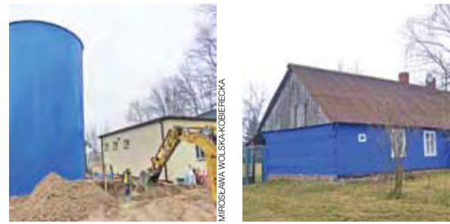
Zbiornik na wodę montowany na SUW i tradycyjna chałupa łowicka, zachowana w Złakowie Borowym.
