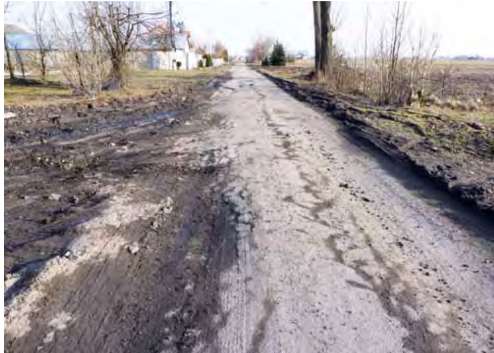
Po zimy droga w Czesławowie, która czeka na kompleksowy remont, rozleciała się całkowicie. Mieszkańcy z niecierpliwością oczekują, że obiecany remont nastąpi jak najszybciej.
