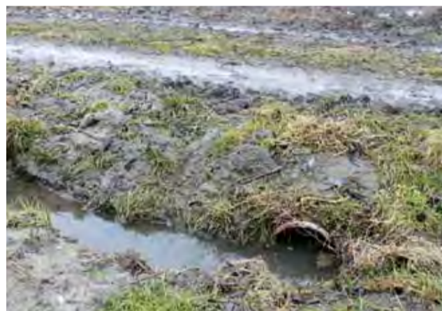
Plastikowa rura wkopana w poprzek drogi, która odprowadza wodę.
