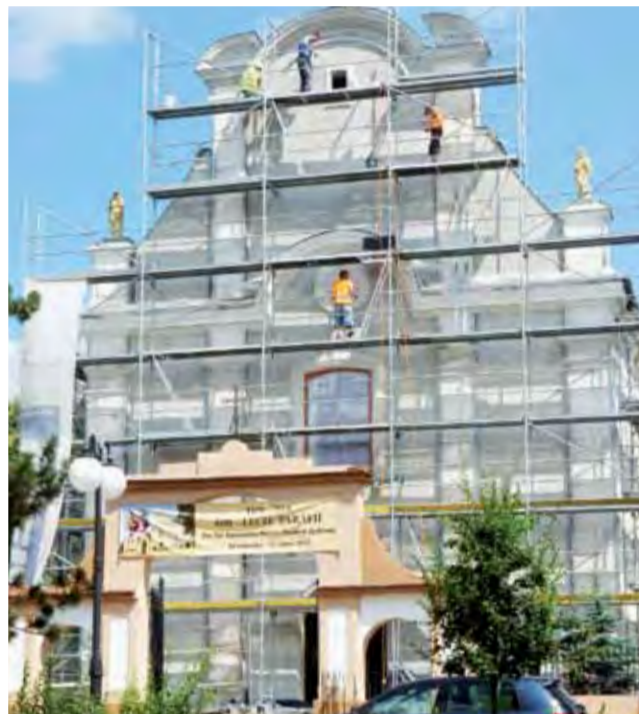
Urząd Marszałkowski w Łodzi stwierdził błąd w postępowaniu przetargowym. Teraz prace ponownie trwają.
