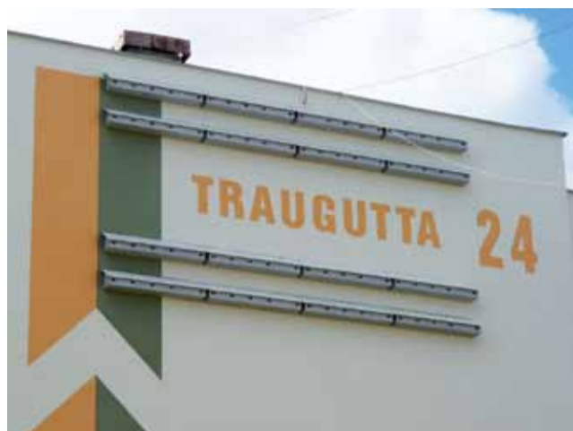
Na dwóch pierwszych docieplanych blokach w Spółdzielni Mieszkaniowej w Żychlinie zamontowano budki lęgowe dla ptaków.
