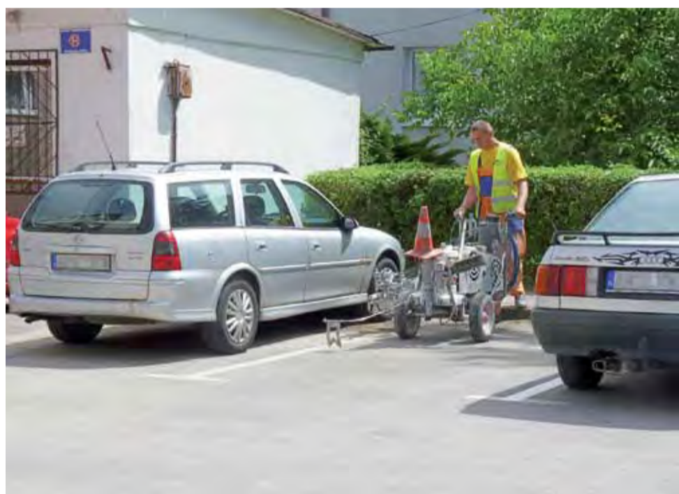
Na zlecenie Urzędu Gminy w Żychlinie trwa malowanie na biało wszystkich przejść dla pieszych oraz miejsc parkingowych znajdujących się na terenie miasta. W wielu miejscach pasów dla pieszych nie było. Już dobrze widać. Teraz będzie bezpieczniej. dag
