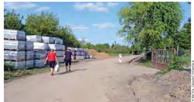
Wykonawca modernizacji ulicy Dobrzelińskiej wyrwał stare krawężniki i gromadzi materiał do budowy.
