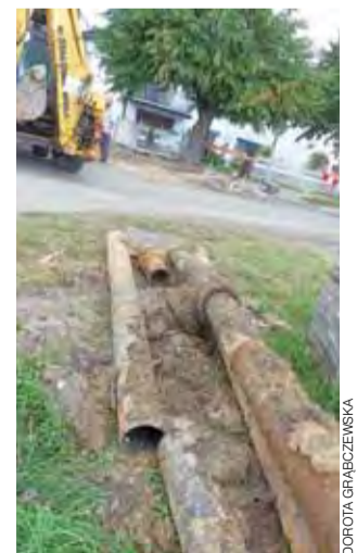
Stalowymi rurami woda pitna już nie popłynie.
