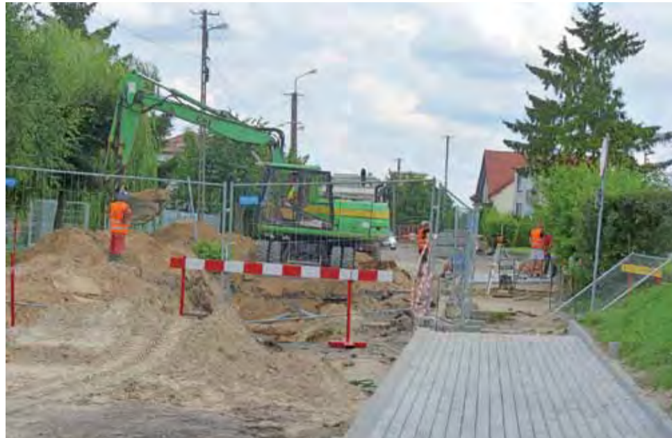
Żartownisie w nocy zabrali przesło ogrodzenia i przenieśli je na ulicę Fabryczną koło Emitu, tym samym odstawiając niebezpieczny wykop.
