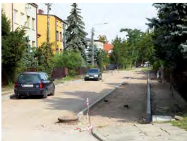
Ulica Słowackiego na odcinku wiodącym do Skweru Ofiar Katastrofy Smoleńskiej od ponad dwóch tygodni zasypana jest tłuczniem.
