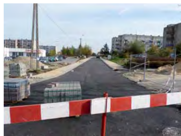
Asfalt na części ulicy Żeromskiego został już ułożony. Mieszkańcy czekają na udostępnienie ruchu w tej części ulicy.
