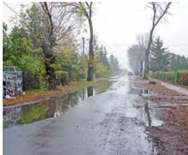
Starostwo wybrało firmę, która wykona uproszczone odprowadzenie ulicy Jabłonkowej w Dobrzelinie, polegające na budowie koryt betonowych odprowadzających wodę do rowu.
